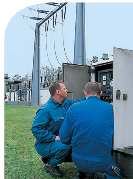
Regelmäßige Kontrolle im Umspannwerk
